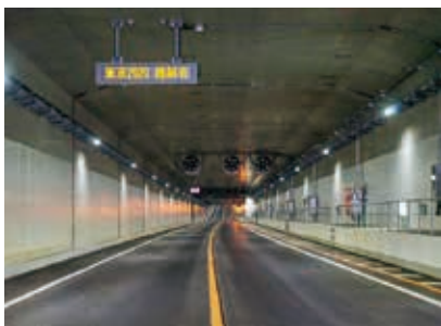
防災等級 AA のトンネル管理設備設置状況（国内）
