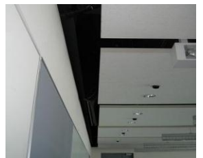
Figure1-4 天井の残留変形
