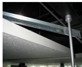
Figure1-3 ブレース上部部材の外れ
