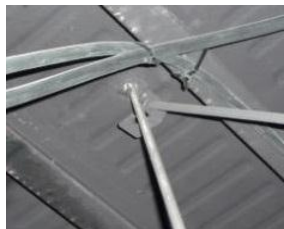
Figure1-5 ブレースの外れ
