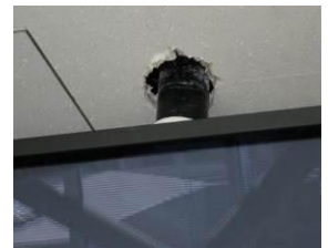
Figure1-2 モニターによる破損
