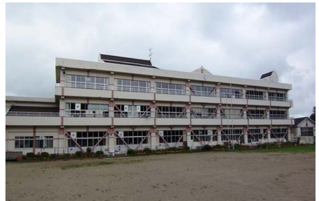
写真1 被災した大崎市の学校校舎の外観
