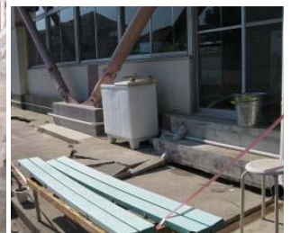
写真4 テラス部分の地盤変状
