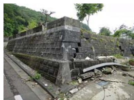
写真4 被災した擁壁
