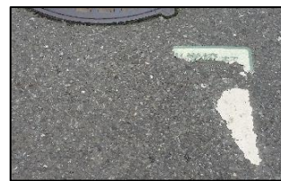
写真 2. ほとんどが剥離した路面シート
